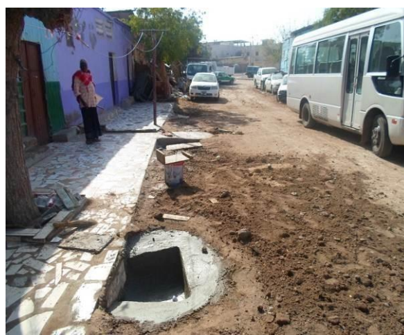
Ouvrage pour eaux grises évités (rue 36)
