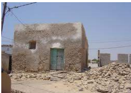
Quelques exemples sur l'état de délabrement du bâti à Obock ; (Photos du Consultant - 2013)
