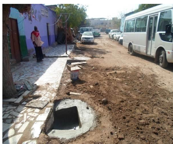
Ouvrage pour eaux grises évités (rue 36)
